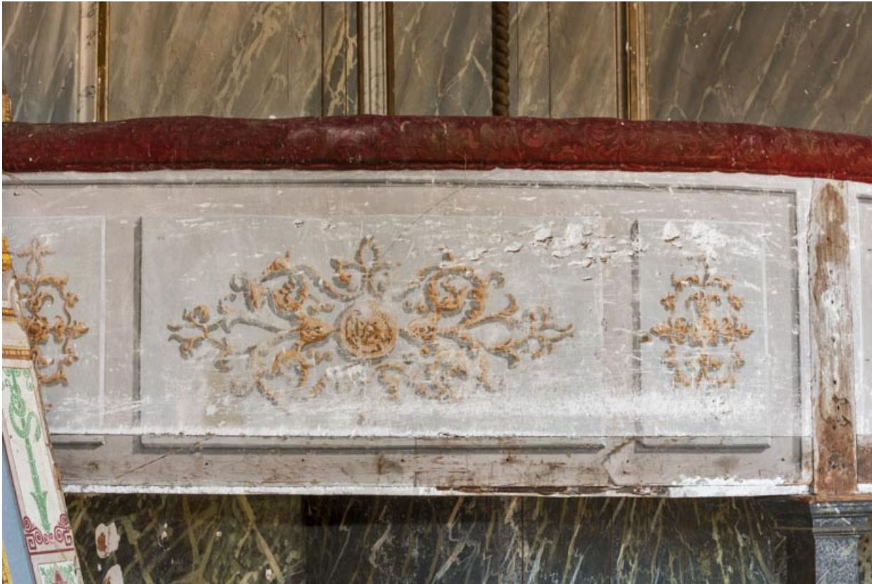
Peinture sur le garde-corps du balcon.
