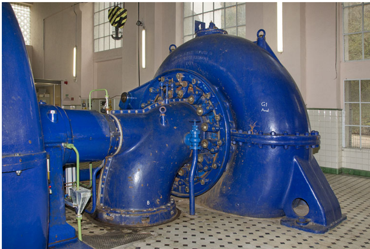
Groupe n° 1 : bâche de la turbine.
