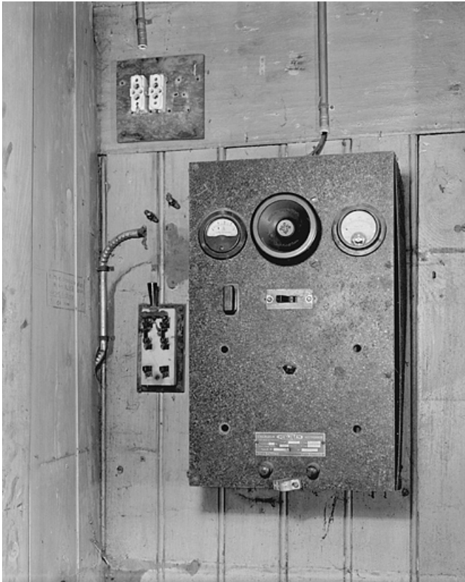
Chargeur de batterie Oxymétal Westinghouse : vue d'ensemble.
