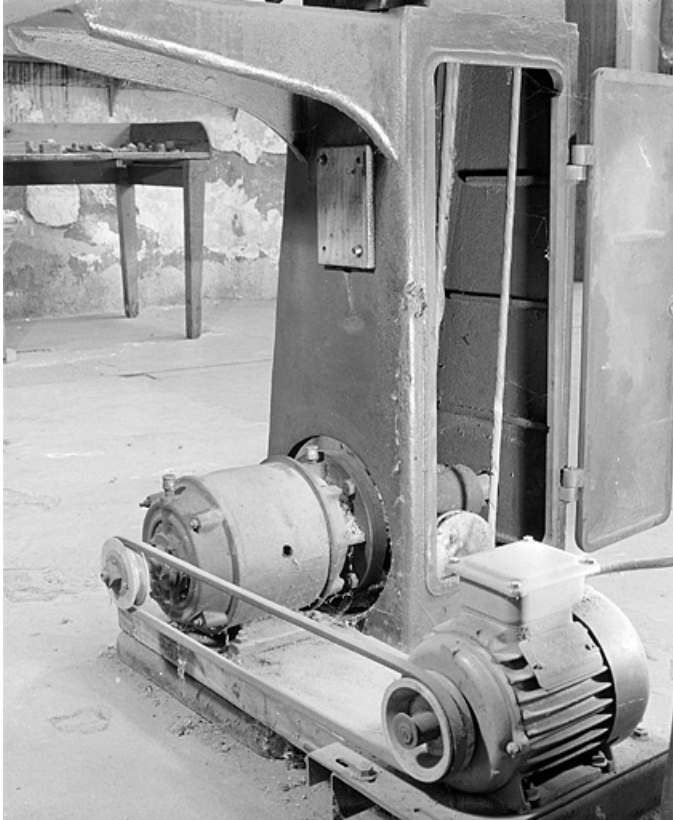
Vue des deux moteurs couplés.
