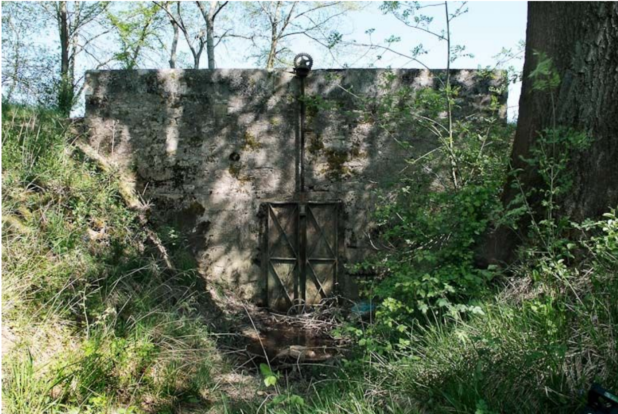
Vanne de l'aqueduc.
