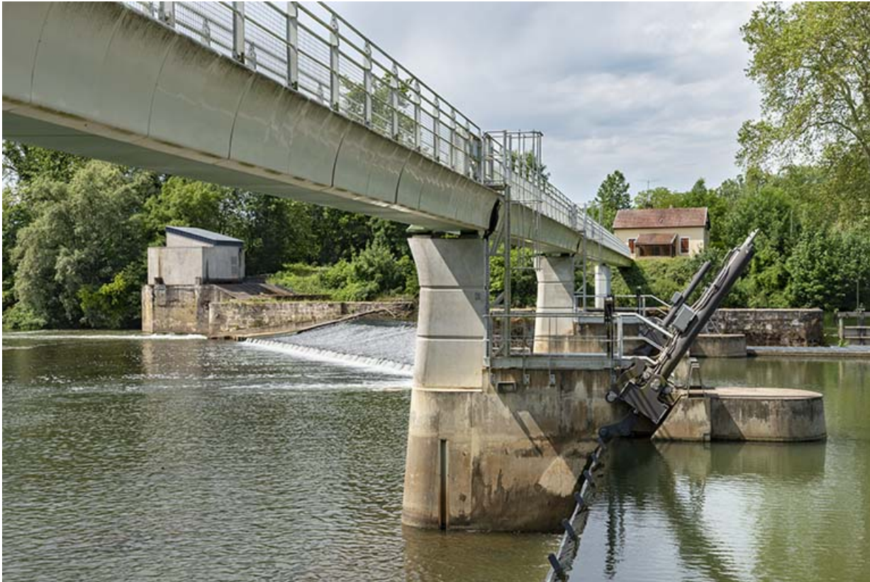
Vue de détail sur les clapets.
