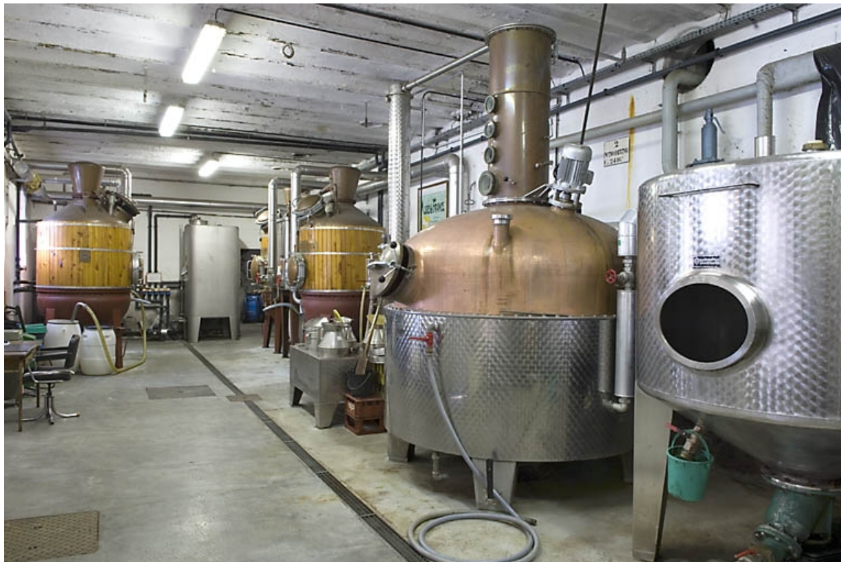
Atelier de distillation. Vue d'ensemble depuis l'entrée.
