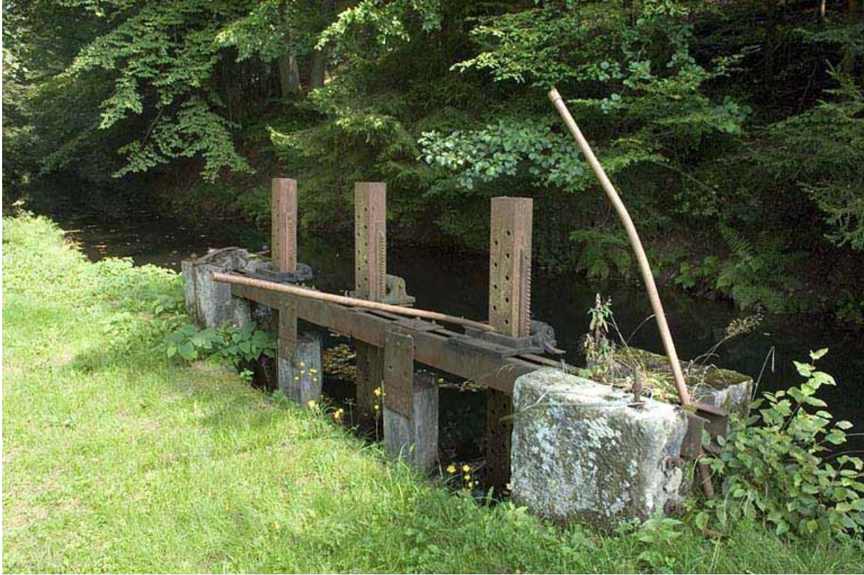
Vanne de décharge sur le bief d'amenée.
