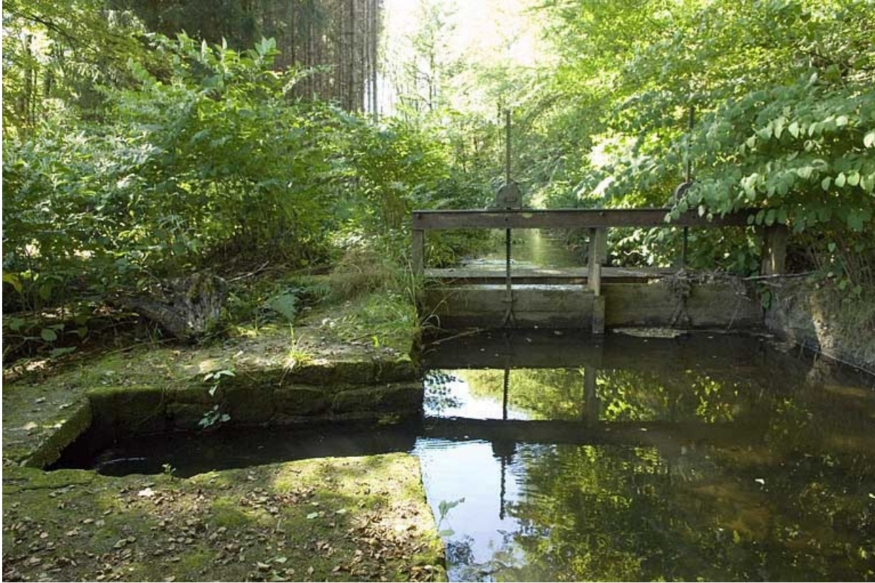
Vannage sur le bief de dérivation.
