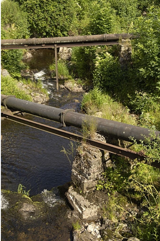
Conduites forcées enjambant le Breuchin.
