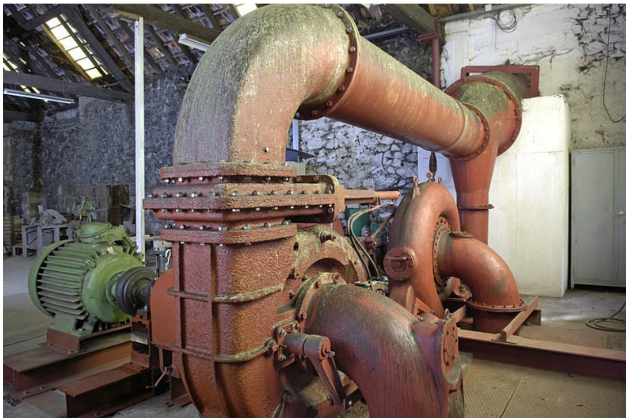
Forge du Haut. Vue rapprochée des turbines.
