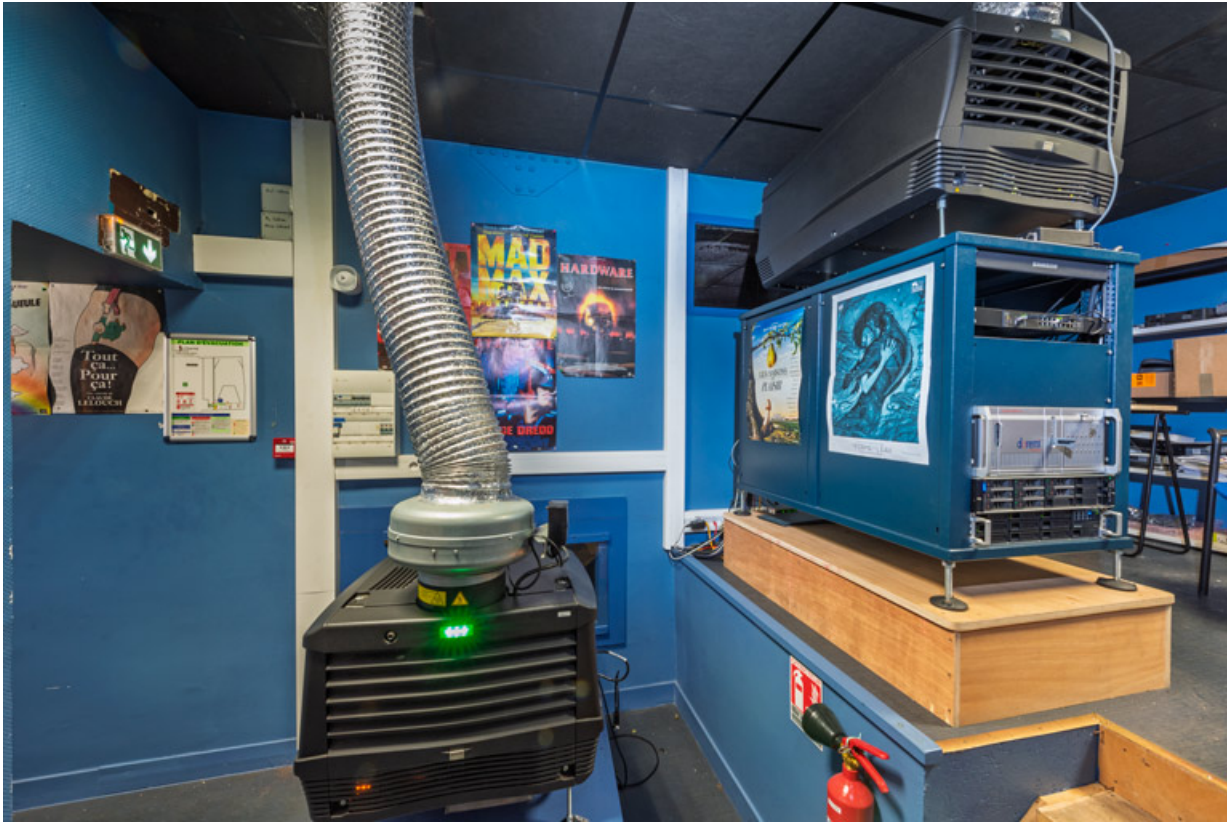
Cabine de projection : projecteurs Barco DP2K12C.
