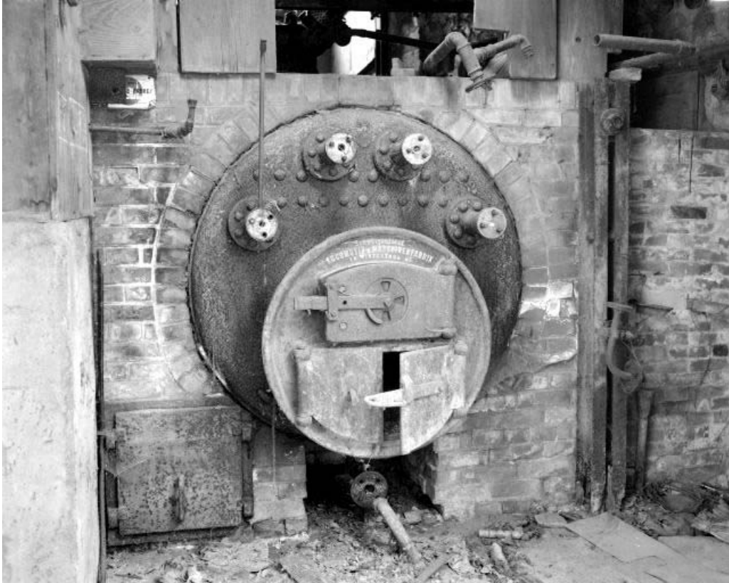
Intérieur de la chaufferie (Q) : chaudière.
