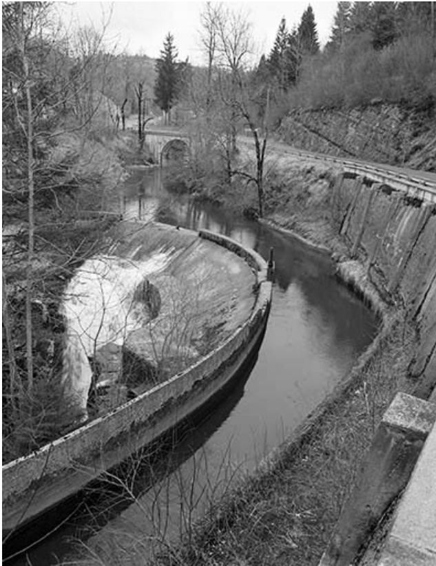
Canal d'amenée de la centrale.
