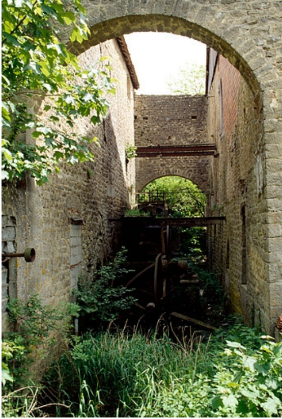
Bâtiment d'eau. Roues hydrauliques en ruine.
