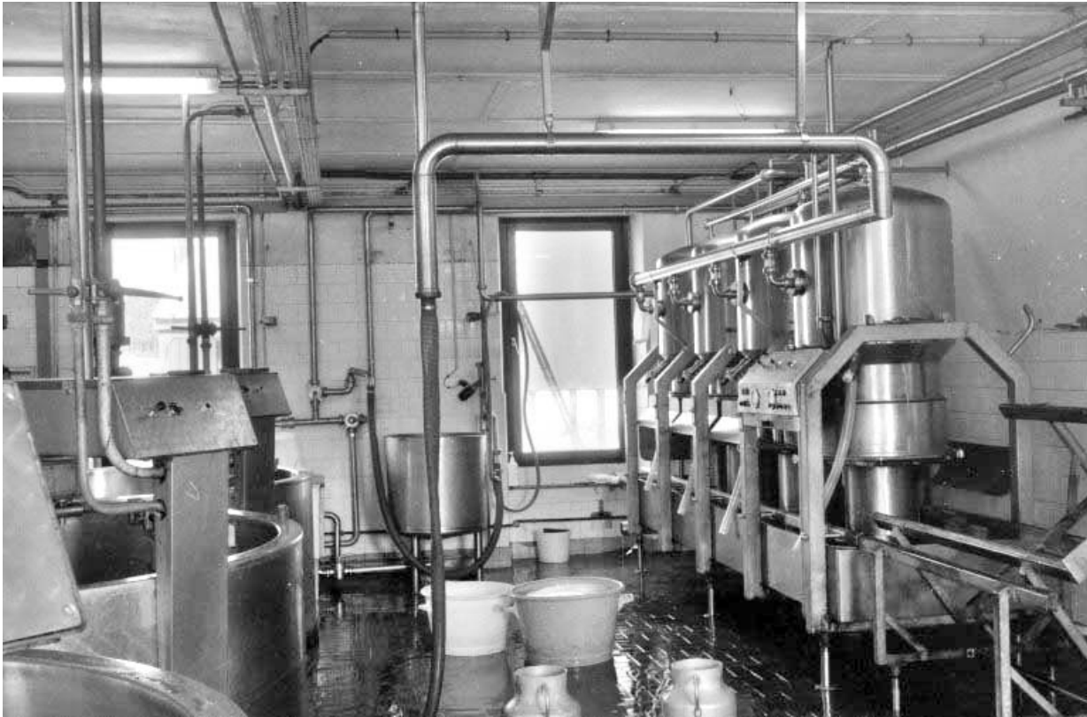
Installation de soutirage. 39, Lac-des-Rouges-Truites
