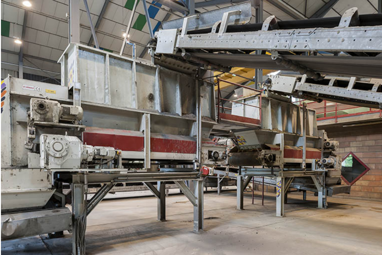
Unité de préparation des terres. Doseurs-tampon.
