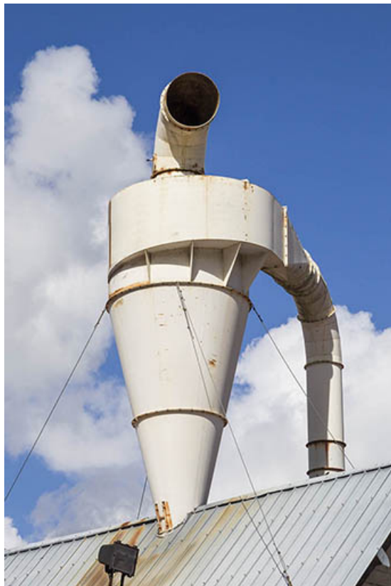
Silo à sciure (L) : cyclone.
