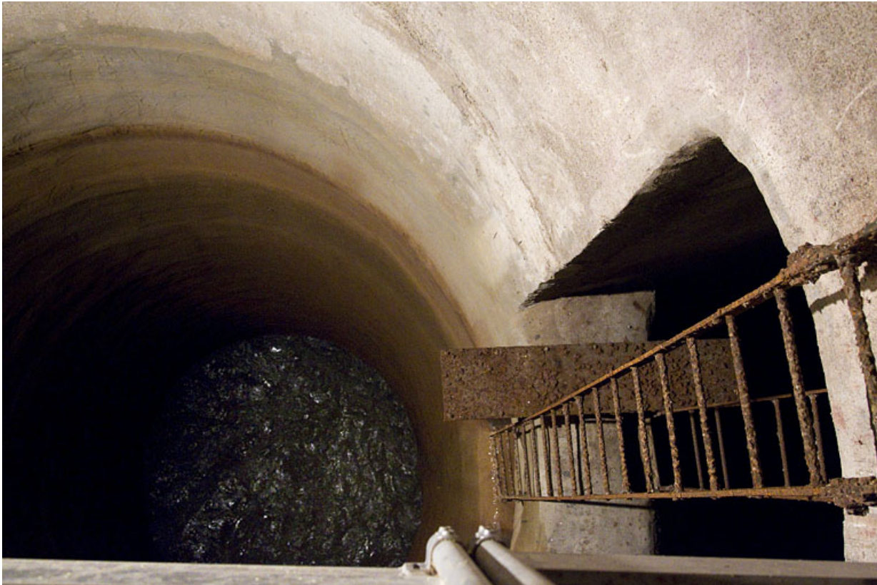
Tunnel d'amenée d'eau : cheminée d'équilibre.
