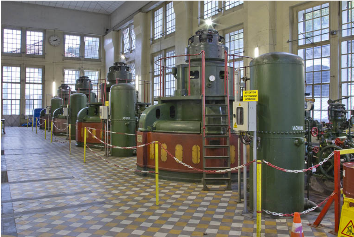
Centrale : vue d'ensemble des groupes (n° 1 à 4).
