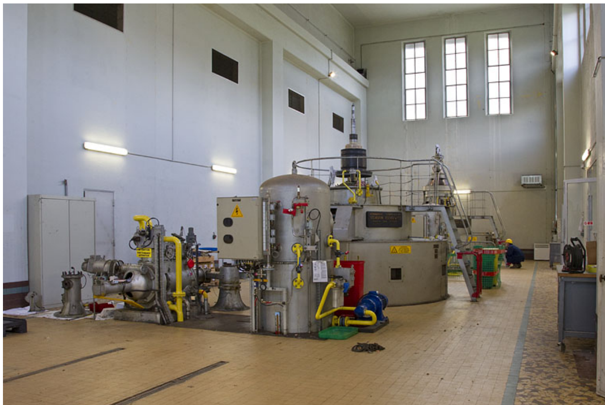
Intérieur de la salle des machines.
