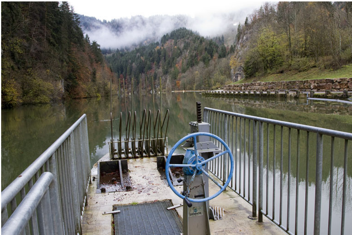
Barrage : commande de vanne de fond.
