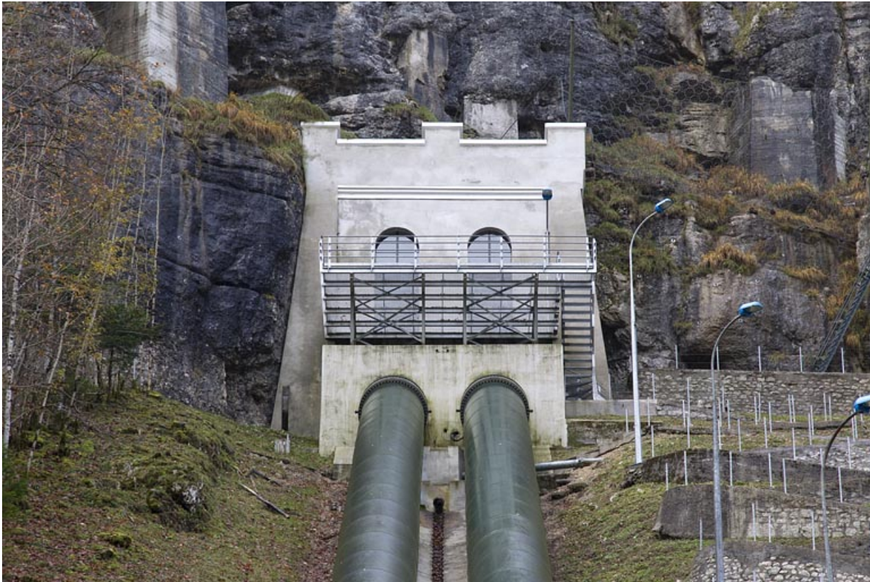
Conduite forcée : chambre de mise en charge.
