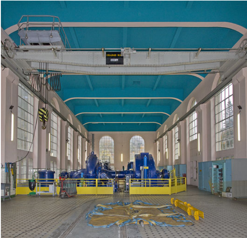
Centrale : intérieur de la salle des machines.
