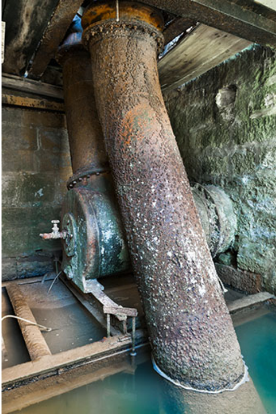
Turbine hydraulique (partie inférieure).
