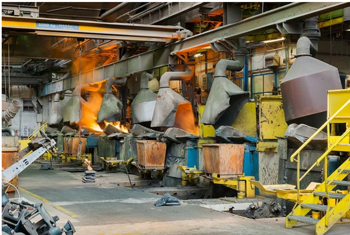
Batterie de fours à induction (3).
