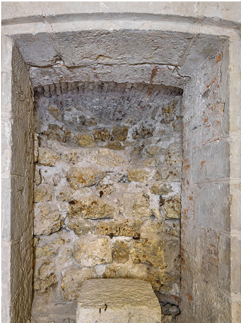
Tour Notre-Dame : ouverture obstruée.
