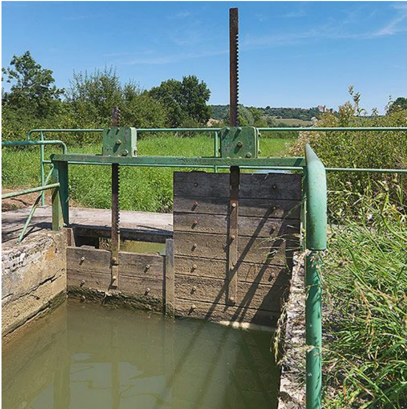
Vannes de régulation sur la rigole.
