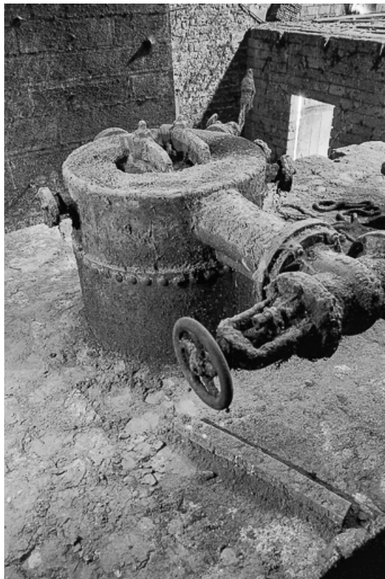
Partie supérieure de la chaudière. Vannage.
