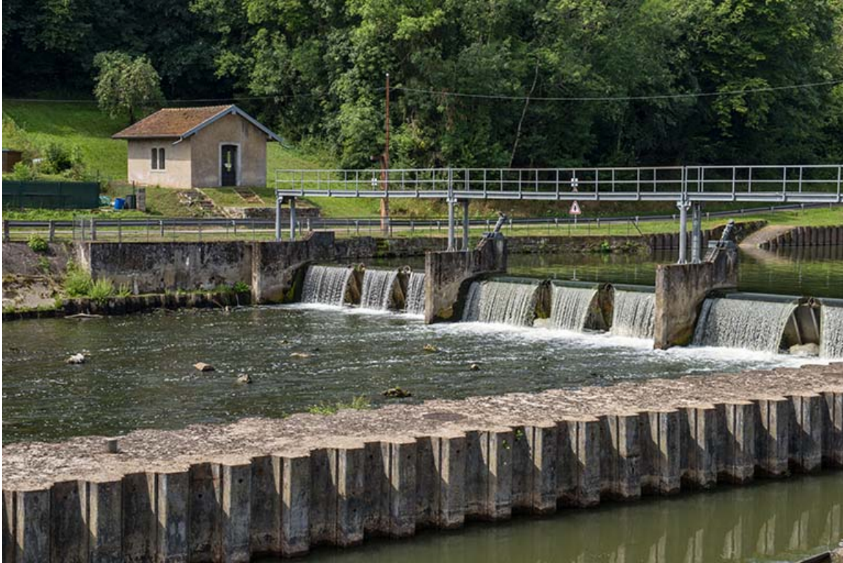
Le barrage mobile.
