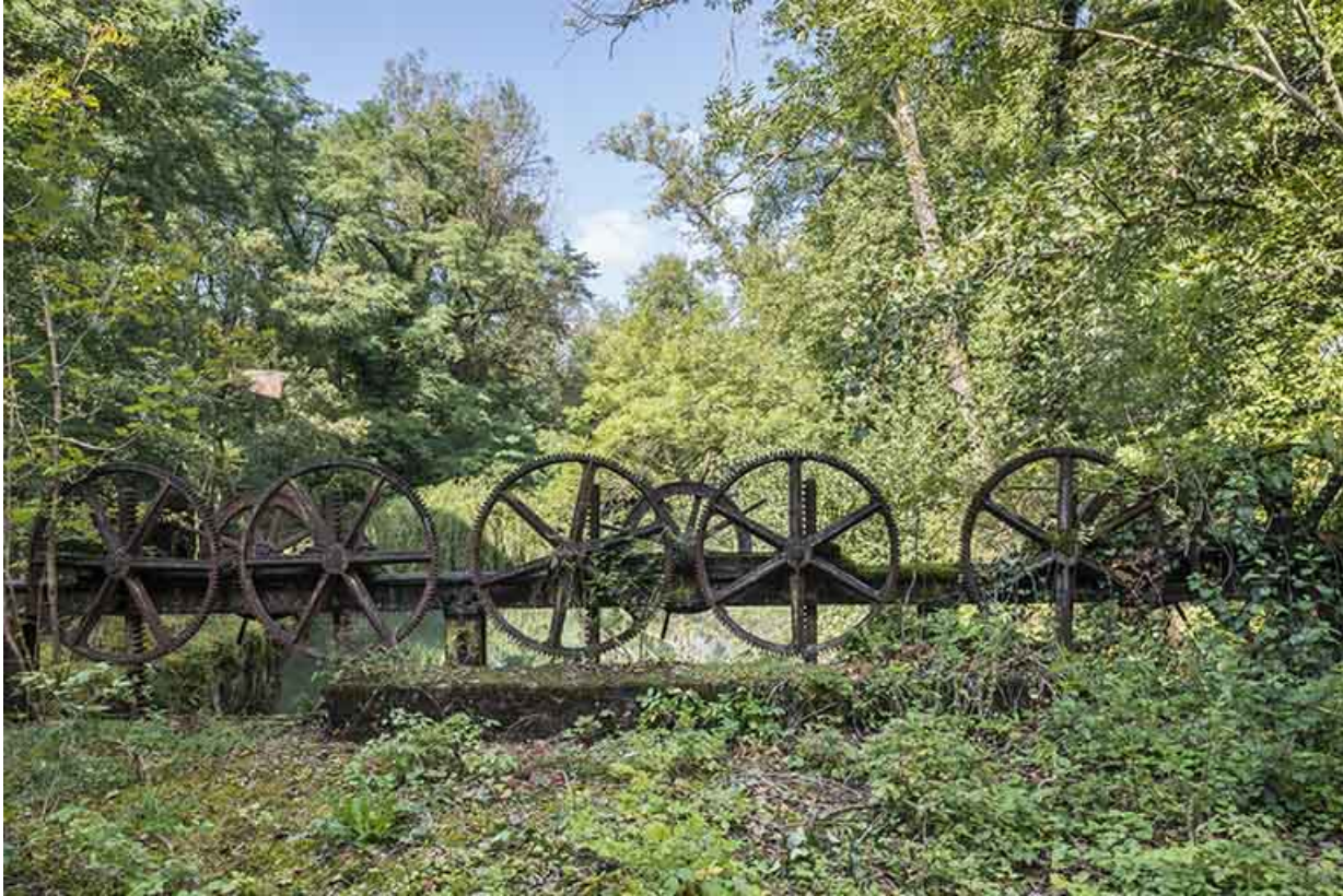
Mécanisme de levage du vannage (canal d'amenée).
