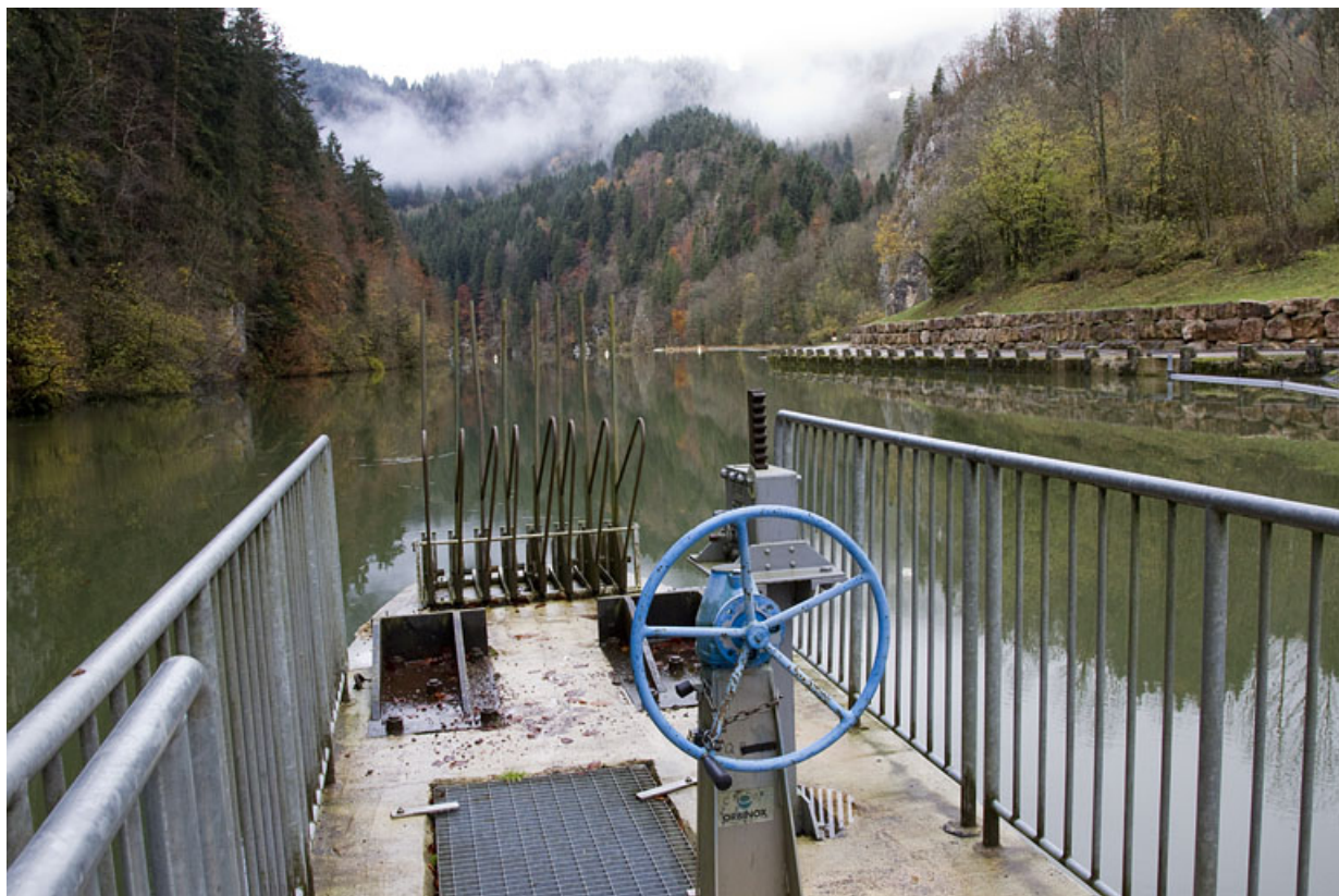
Barrage : commande de vanne de fond.
