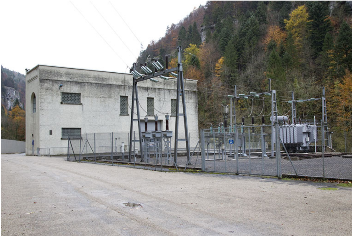
Centrale (façade antérieure) et transformateur.
