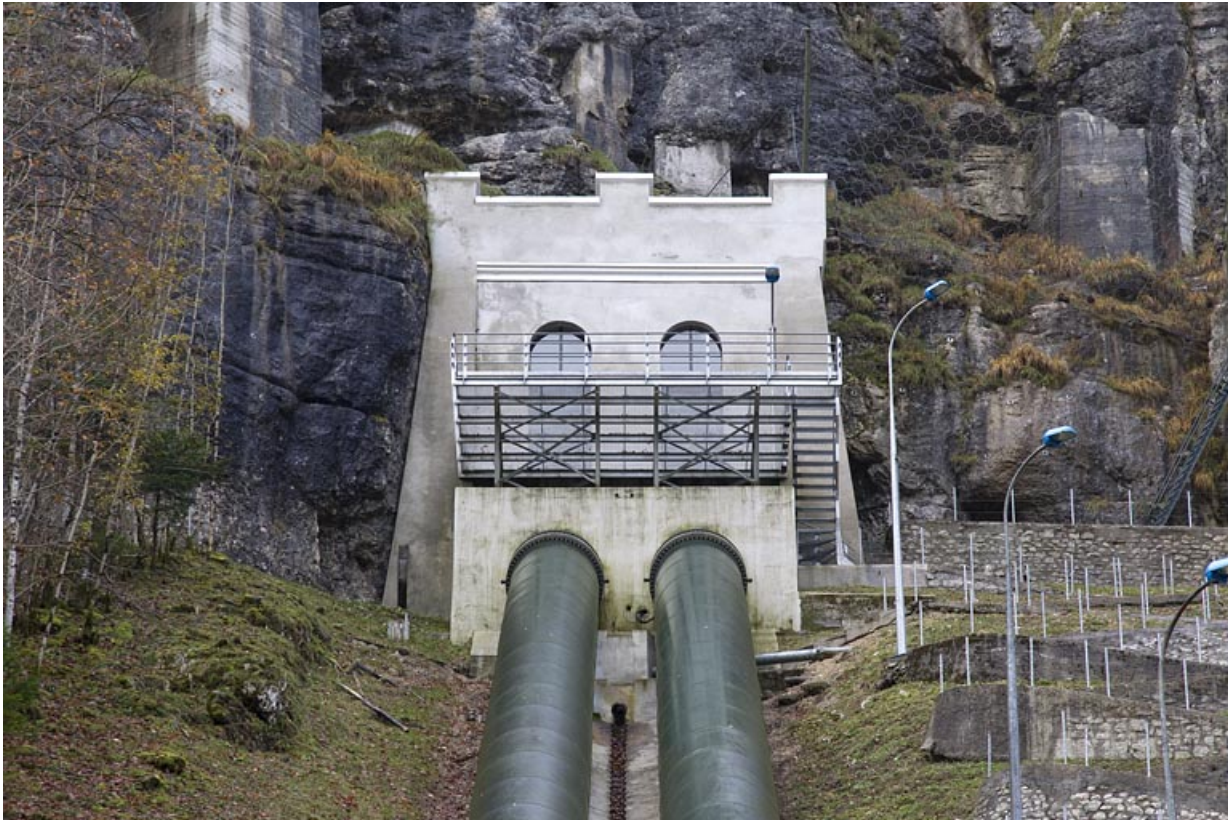
Conduite forcée : chambre de mise en charge.
