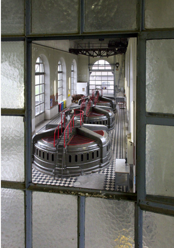
Vue plongeante sur la salle des machines.
