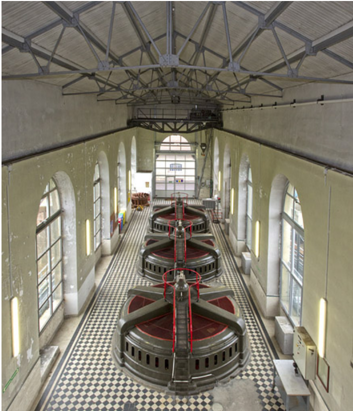
Salle des machines. Alignement des groupes turbo-alternateurs.
