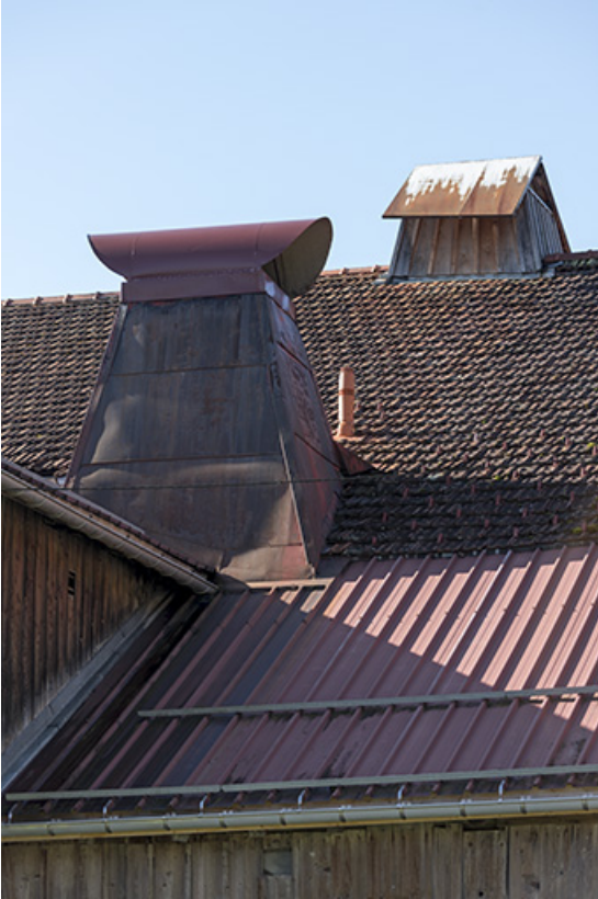
Pan de toiture nord, avec deux "tués".
