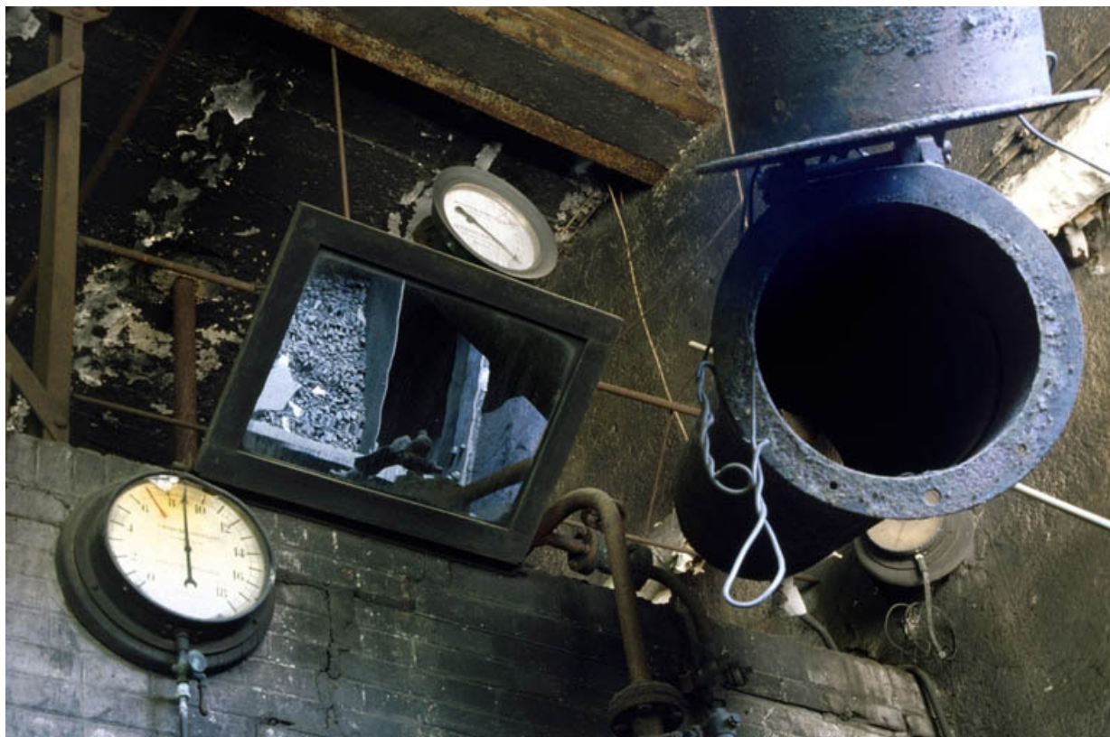
Détail de la partie haute de la chaudière (1927). A droite : tuyau articulé de chargement de la trémie.
