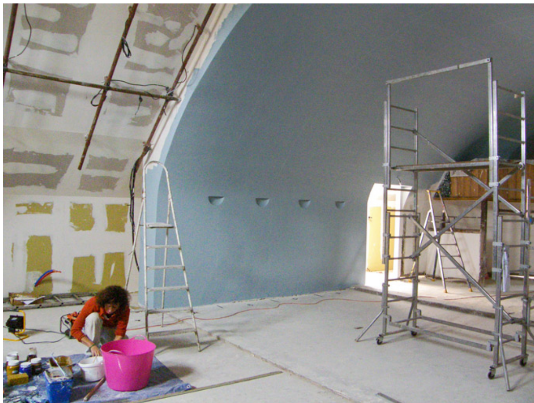
[Réfection des peintures de la voûte : préparation par la restauratrice]. 2008. 89, Brienon-sur-Armançon, 2 place Emile Blondeau
