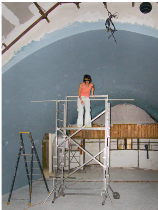
[Réfection des peintures de la voûte : la restauratrice sur l'échafaudage]. 2008. 89, Brienon-sur-Armançon, 2 place Emile Blondeau
