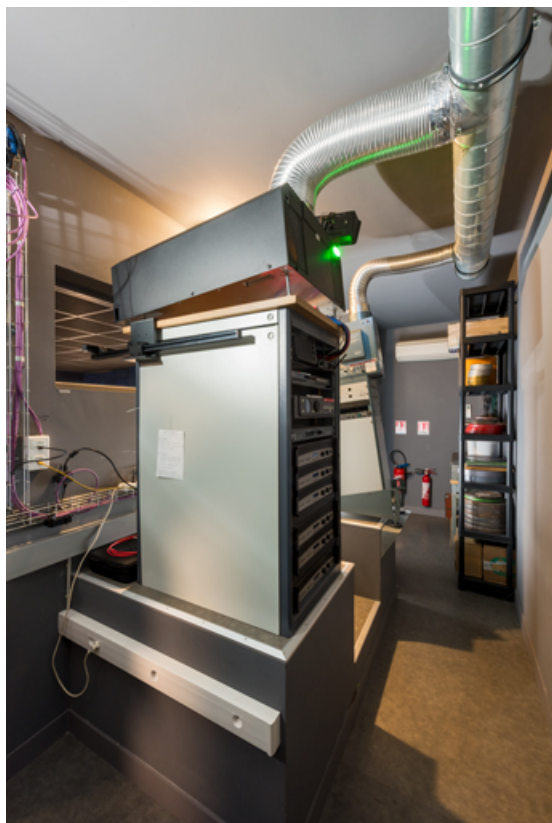
Cabine de la salle 4. Projecteurs numérique Barco (à gauche) et argentique Hortson. 71, Autun, 3-5 rue Pernette
