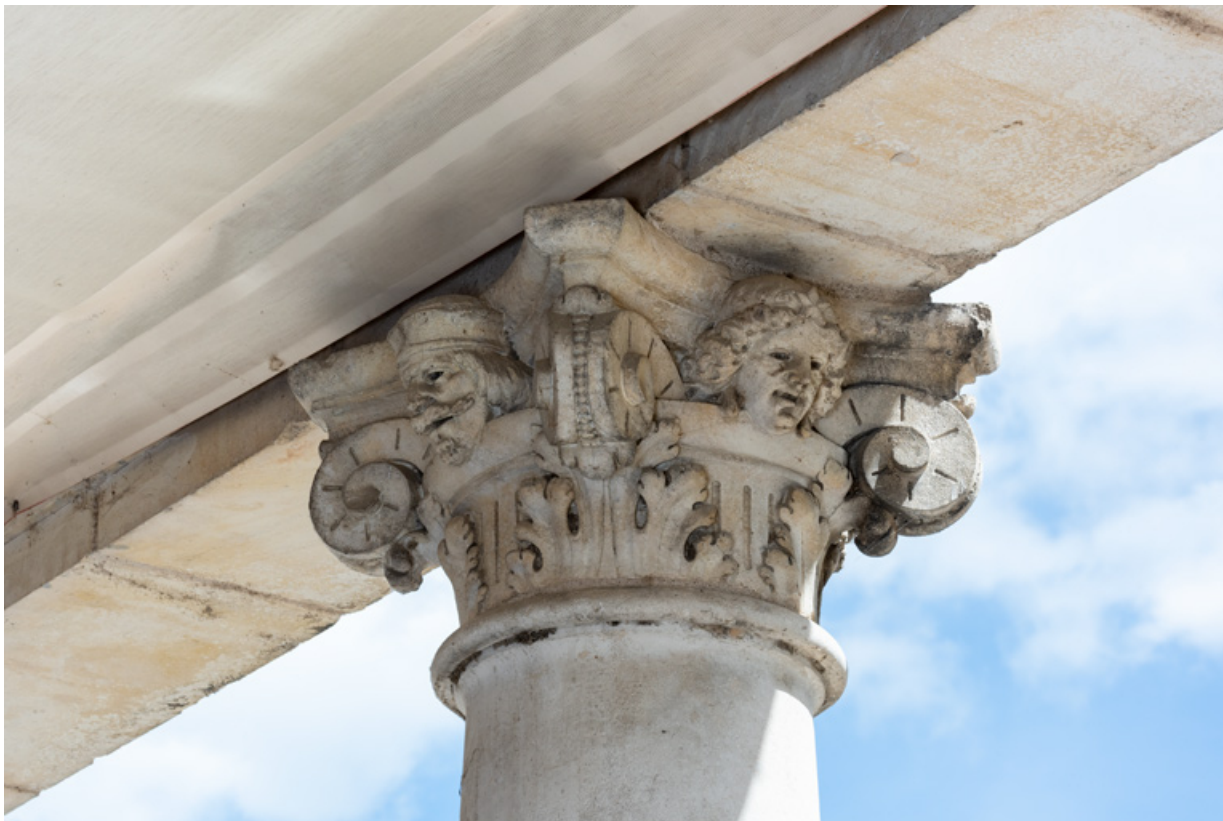
2e colonne, chapiteau : deux têtes (sur les faces arrière et gauche). 58, Nevers, 8 place des Reines de Pologne
