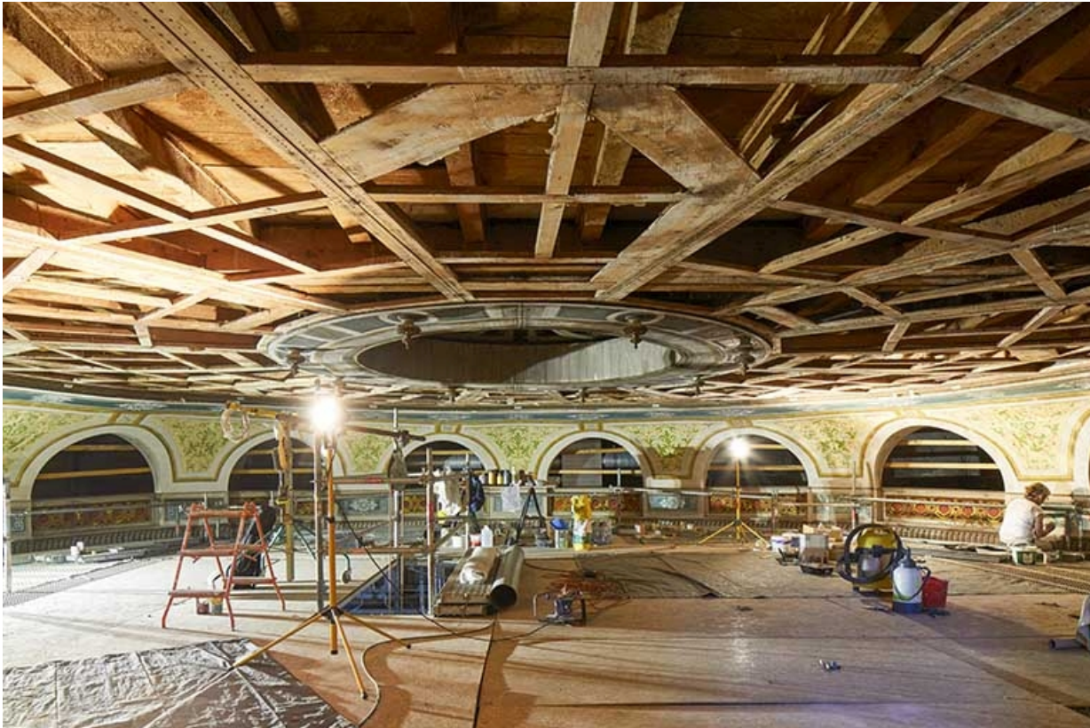
Plafond de la salle en cours de restauration, en 2020. Les peintures ont été enlevées, révélant la structure en bois de la fausse coupole.
