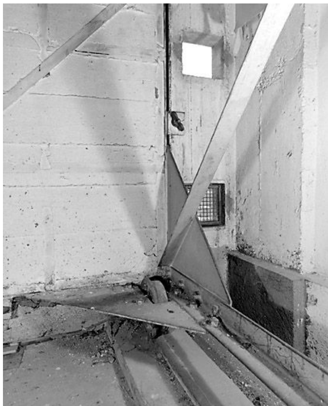
Roue et chemin de roulement du chariot mobile portant le cadran extérieur.
