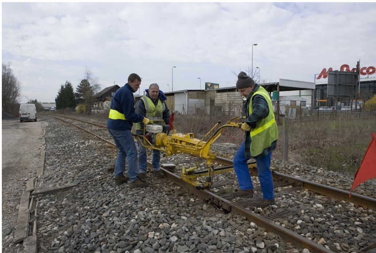
Mise en place par les agents de l'Équipement. Les agents placent le corps de la tirefonneuse sur son bâti, positionné sur les rails. in, Jura
