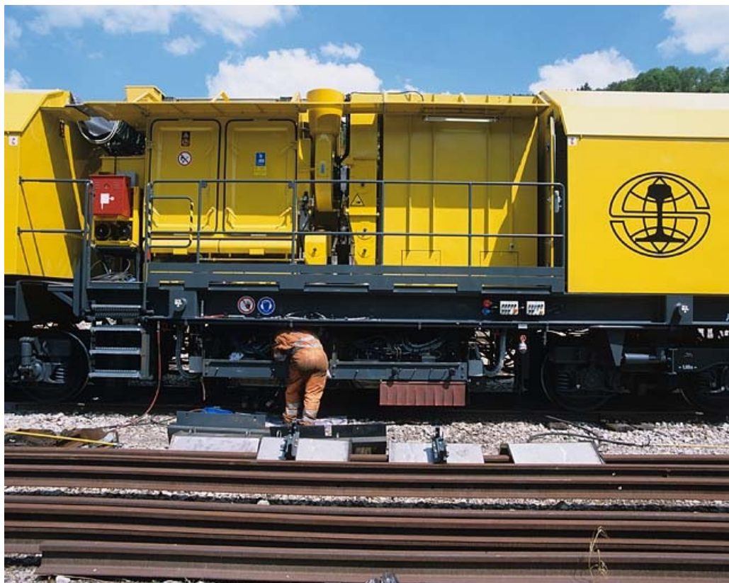
Train de meulage : maintenance et réglages sur l'un des wagons. in, Jura
