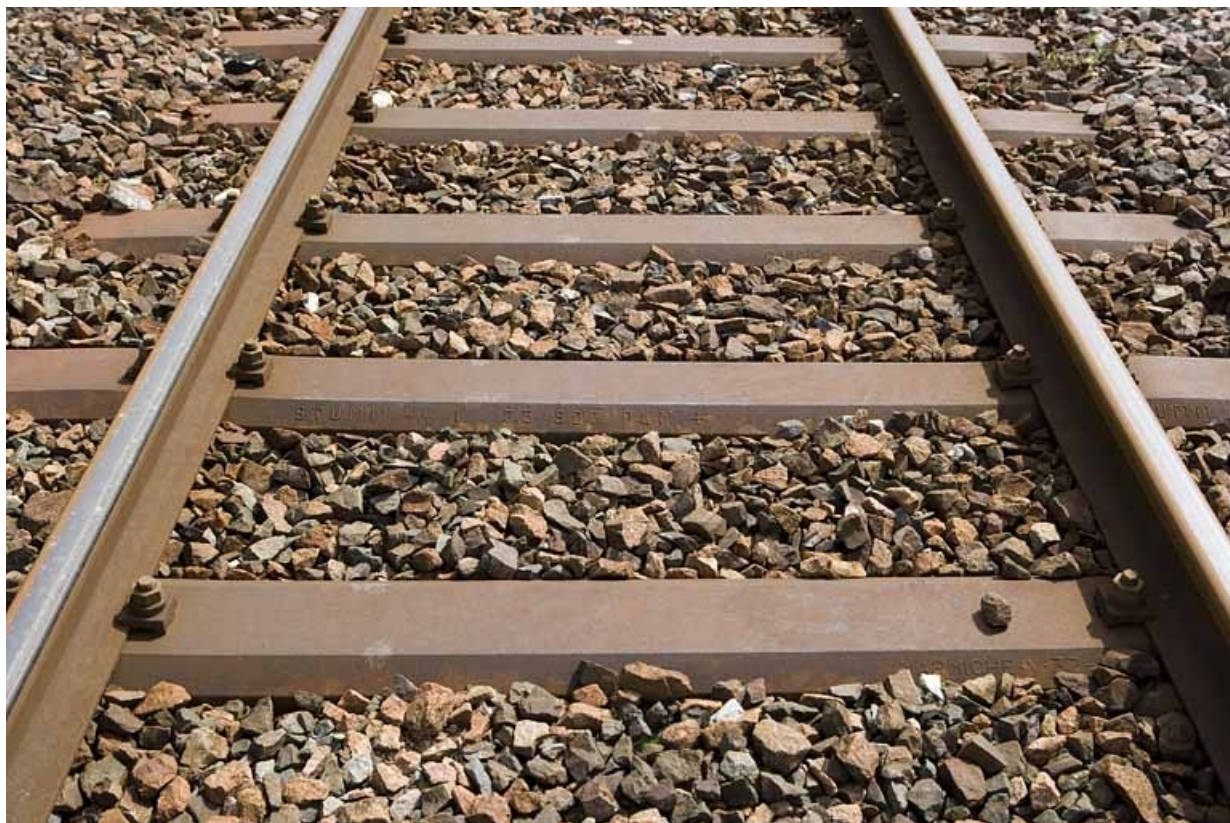
Traverses métalliques simples près du point kilométrique 012.000 (commune de Champagnole) : Stumm. in, Jura
