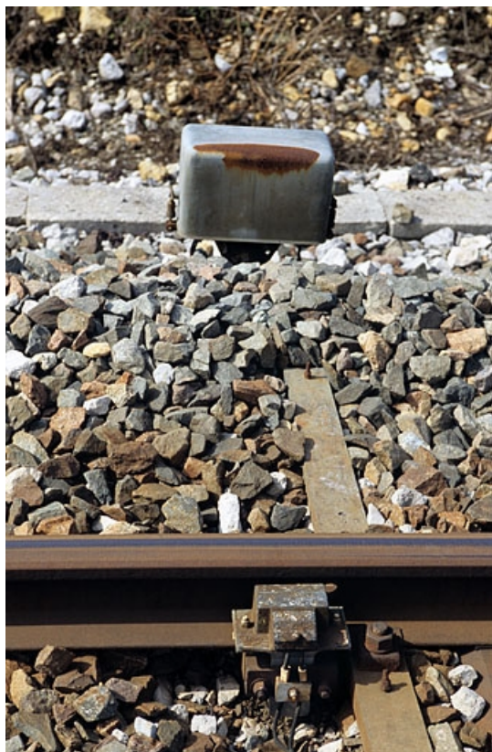
Pédale électronique : vue d'ensemble. Cette pédale commande le contrôle de zone d'un passage à niveau.
