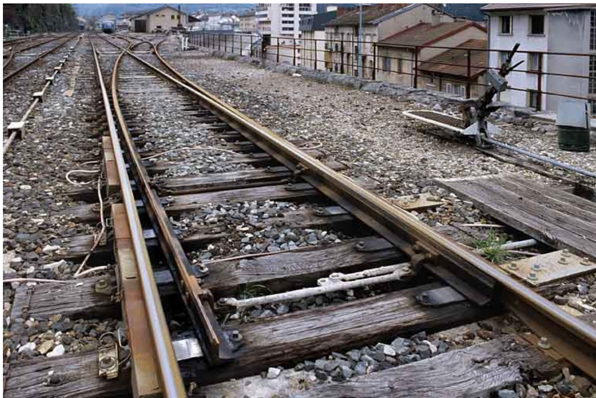
Aiguilles sur la voie 1 (A), vers la remise ferroviaire. Raccordement des voies 3, 5, 7 et 7 bis sur la voie 1. Rampe de réchauffage au gaz à gauche, levier de manoeuvre enclenché à droite.
