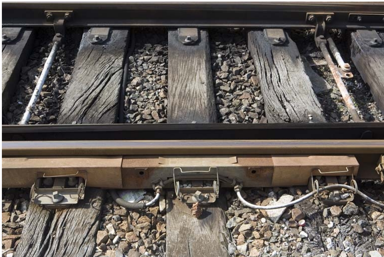
Exemple de rampe de réchauffage au gaz, sur un autre appareil : la rampe en place.
