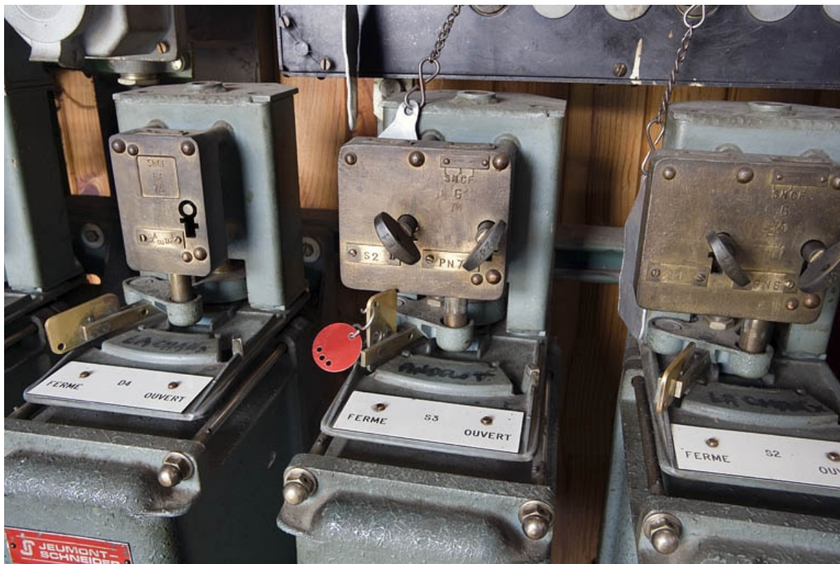
Petit dispositif en place sur la manette d'un commutateur.
