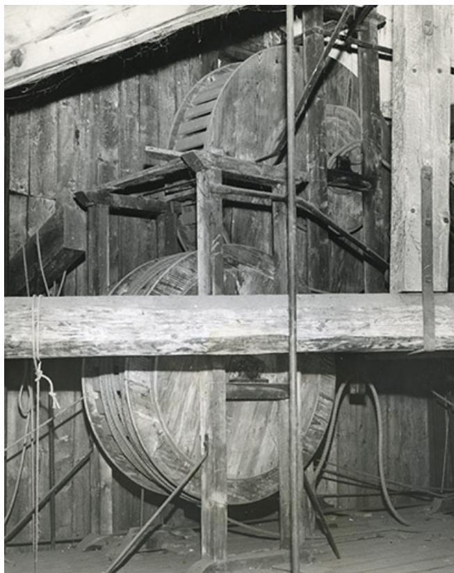
[Le Kursaal avant et pendant les travaux], 1980-1982 : [machinerie en bois sur le grill], s.d. [1980 ?]. 25, Besançon, 2 place du Théâtre
