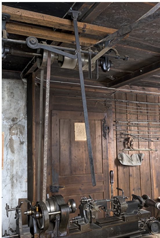
Système de transmission au plafond.
