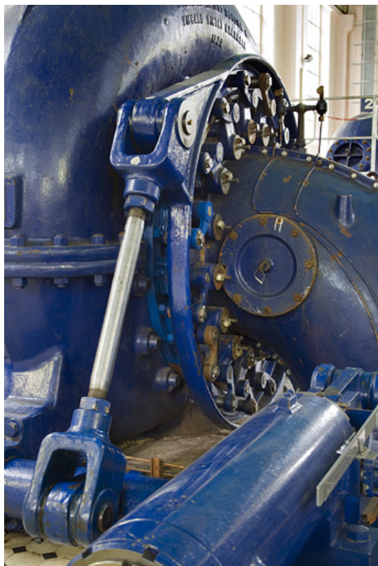
Groupe n° 1 : bras et cercle de vannage de la turbine, permettant d'en régler le débit.
