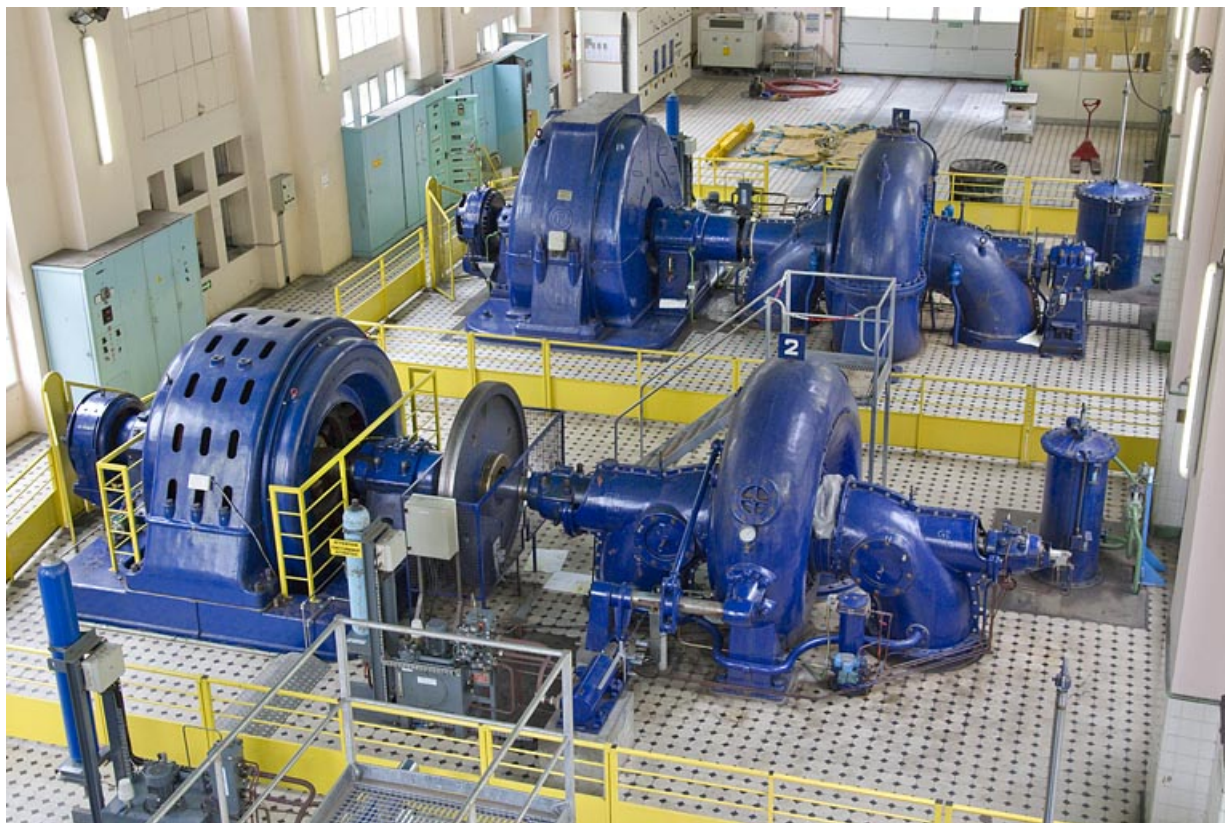
Vue d'ensemble plongeante sur les groupes n° 1 et 2.
