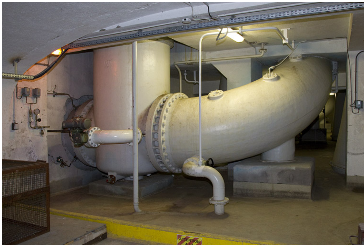
Groupe n° 1 : conduites d'amenée d'eau, à l'étage de soubassement. 25, Charquemont, lieudit : Mortier
