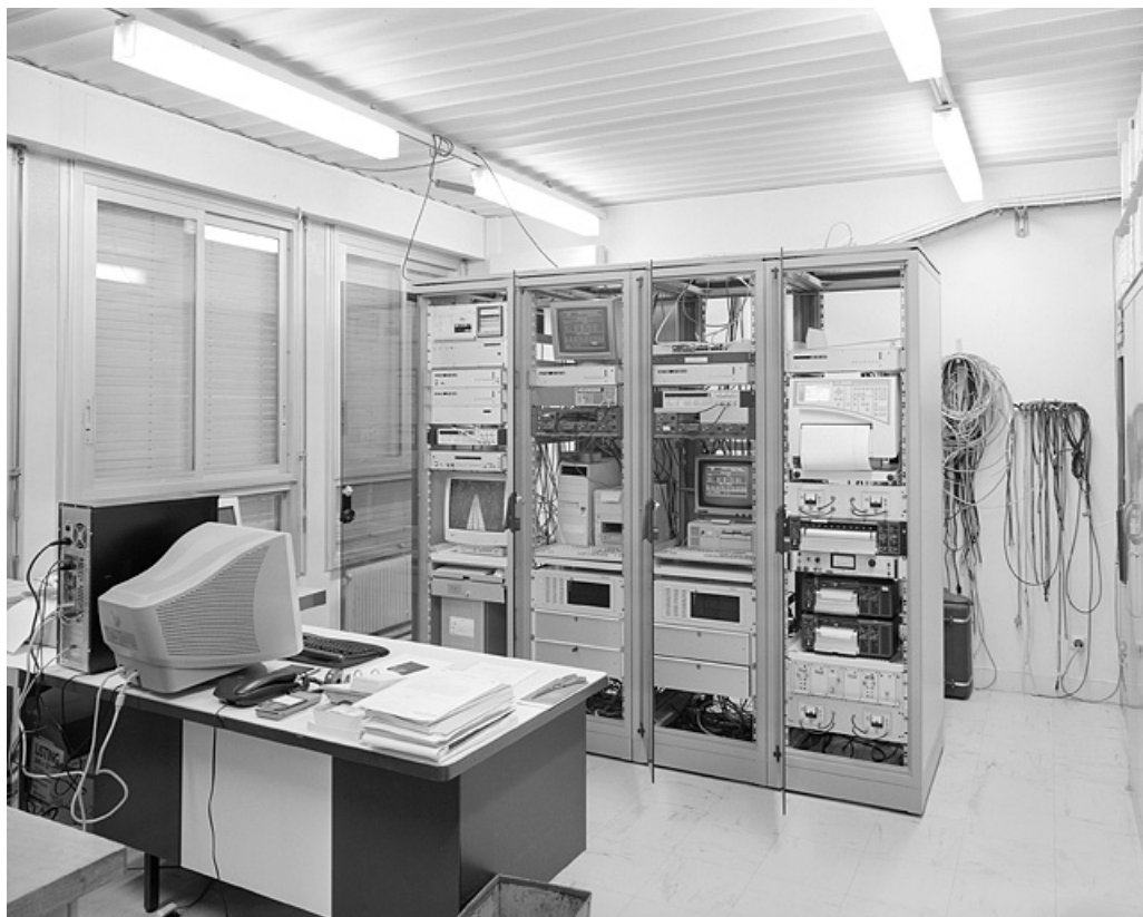
Équipement permettant la comparaison des horloges atomiques et la participation au Temps atomique international. 25, Besançon, 34, 36, 41 à 43 avenue de l' Observatoire, lieudit : la Bouloie
